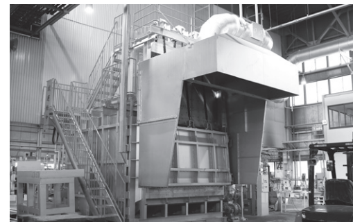
塩田工場に増設した溶解設備(6トン溶解炉)
