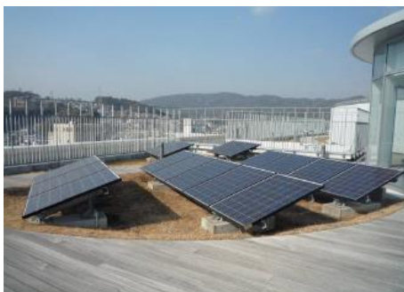
太陽光パネル
