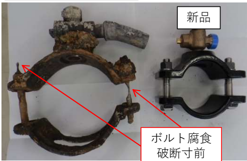
ボルトの腐食
