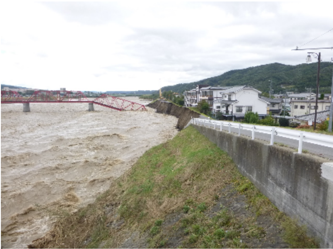
千曲川左岸堤防の欠損と上田電鉄別所線鉄橋の落橋（諏訪形）
