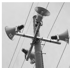
城北自治会 (屋外放送設備)
