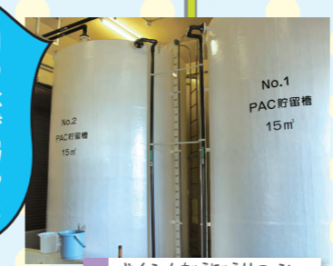
薬品注入設備
