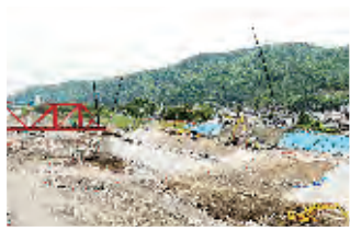
10 復旧を進める別所線の千曲川橋梁
