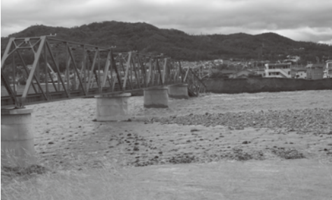
令和元年東日本台風により被災した「別所線千曲川橋梁」
